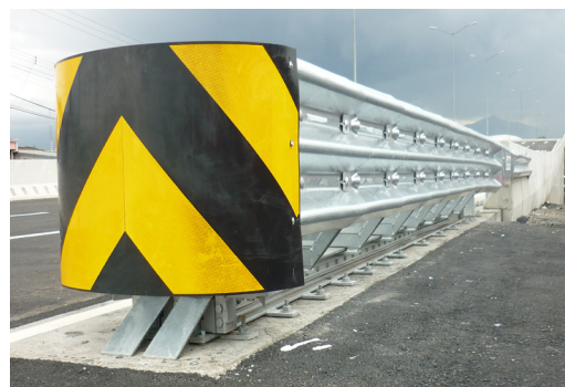
Figura II-3 Atenuador de impacto instalado en acceso al Puente sobre Rotonda Del Rancho de Guanacaste
